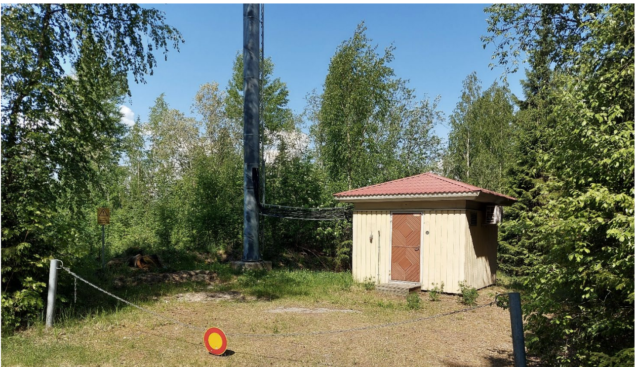
Teleliikennemasto Hiekkapohjantien varressa
